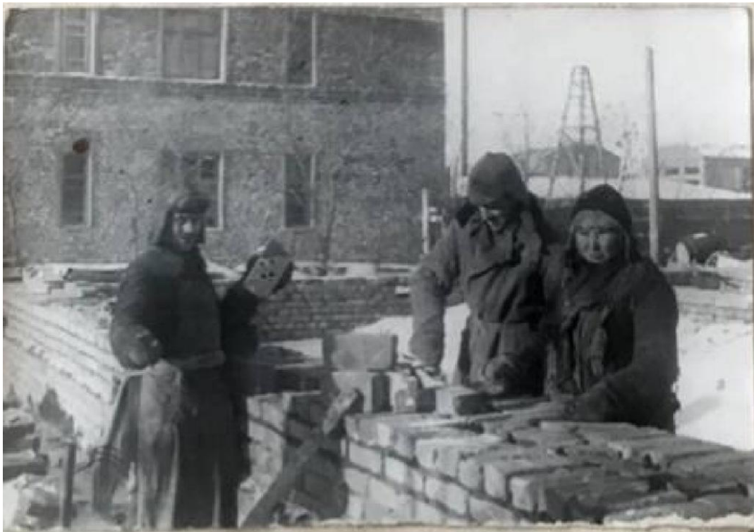
Сурет 1 – Орал қаласындағы К.Е. Ворошилов атындағы № 231 зауытқа қарасты екі қабатты тұрғын үйдің құрылыс жұмыстары. (ҚР ПА. 708 қ. 8 т. 1734 і. 7 п.) [Figure 1 – Construction work of a two-storey residential building belonging to Plant No. 231 named after K.E. Voroshilov in the city of Oral. (AP RK. F. 708. Inv. 8. C. 1734. P. 7)]
